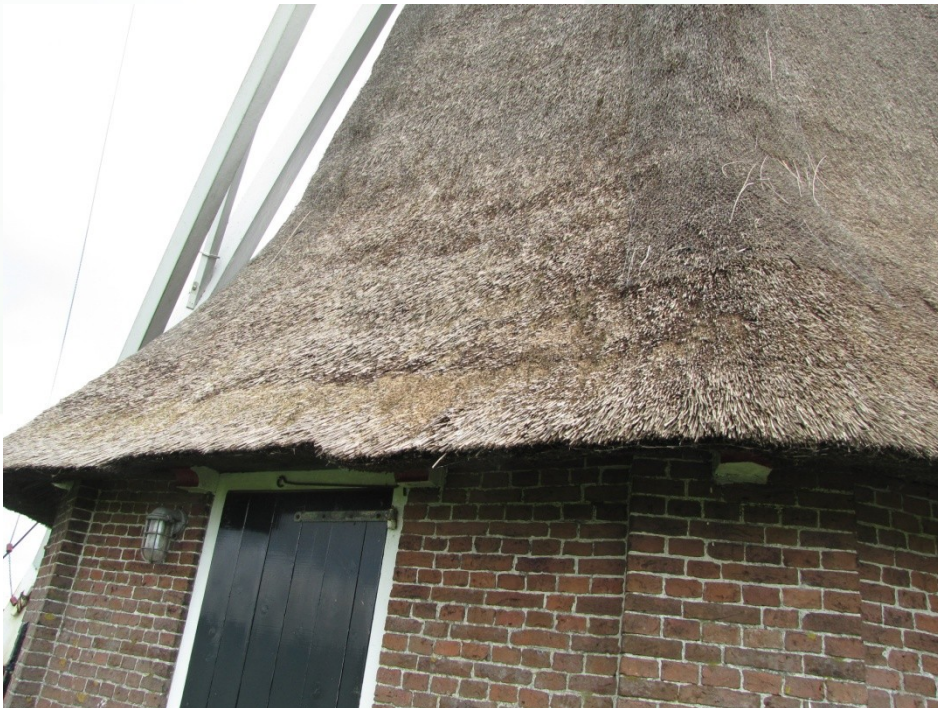
Rietdekwerk van kap en achtkant worden plaatselijk bijgestopt en opgeklopt.
