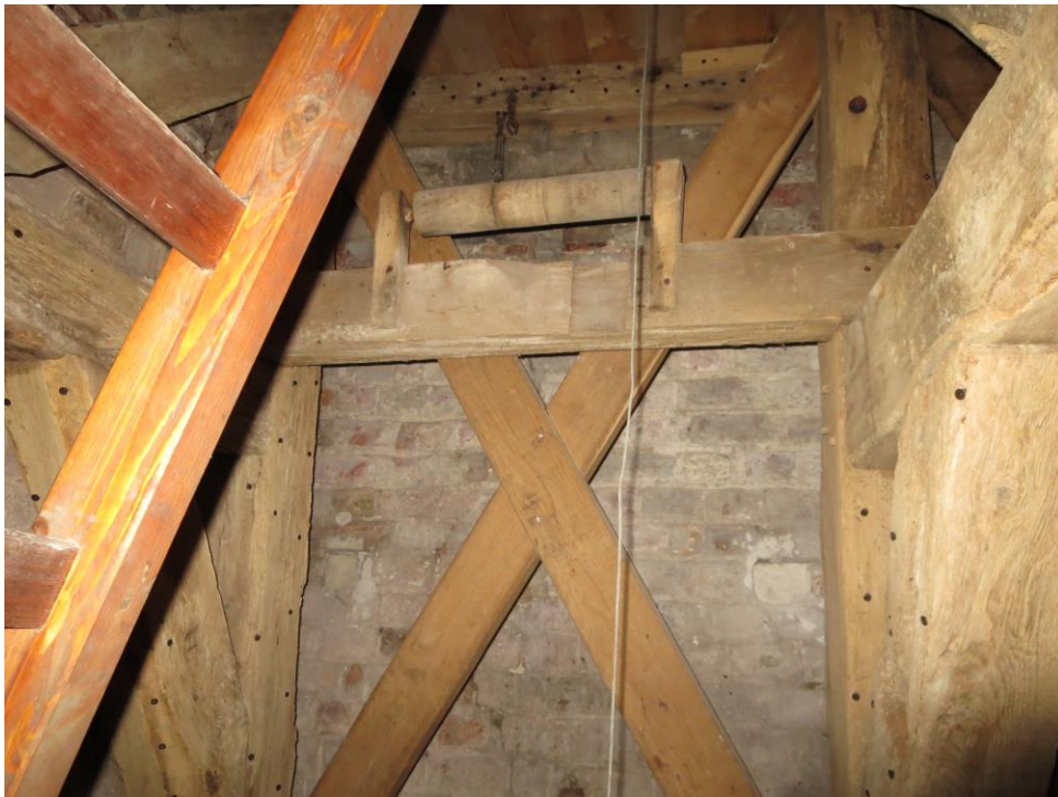
Afb. 2. Balk (met houten rol) waaraan een voorziening voor bevestigingshaken/ogen voor katrollen moet worden bevestigd
