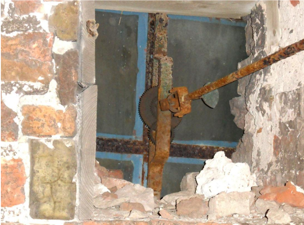
Afb.3 Wijzerwerk, vervuild, geroest en niet gesmeerd
