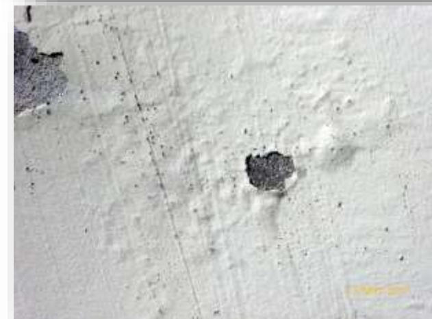
Situatie 2017 toren moet volgend jaar opnieuw in de steigers
