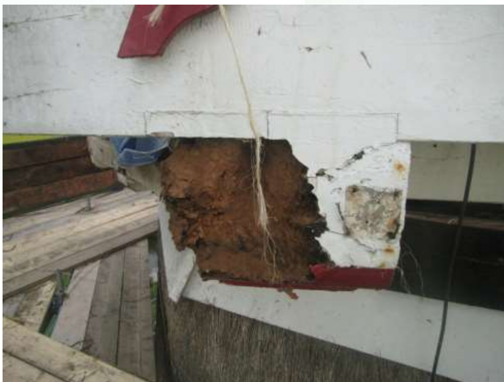
28 juni 2016. Door houtrot aangetaste voeghoutkop achterzijde kap.
