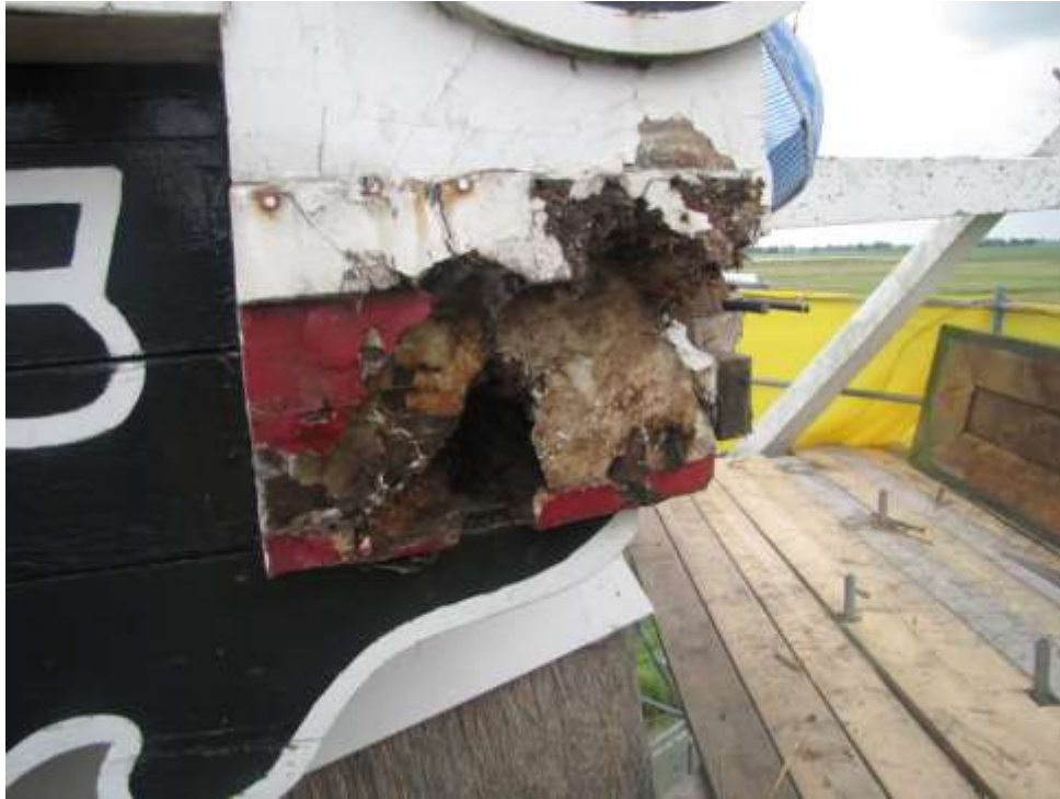
28 juni 2016. Door houtrot aangetaste voeghoutkop voorzijde kap.
