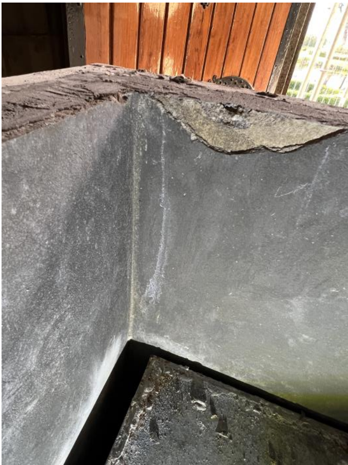
Weggefallen schilfer bepleistering aan de voorzijde en rechts boven bij de tussenwand.
