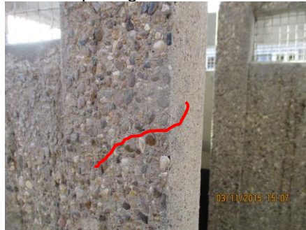
Scheurvorming in de stijl.
