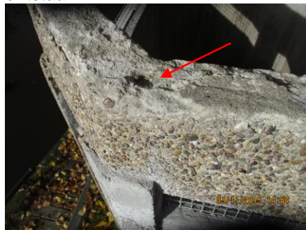
Weggefallen delen van afwerklaag.
