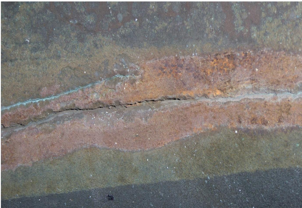
Binnenzijde gescheurde slagrand
