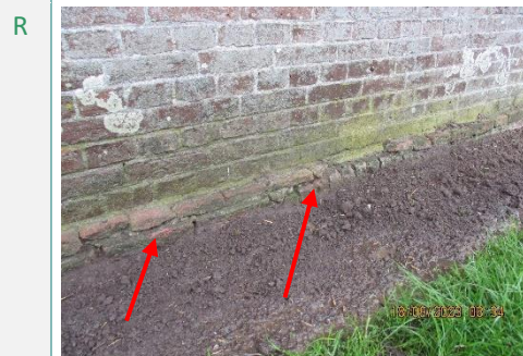
Het maaiveld is gezakt; open voegwerk langs het maaiveld. Baksteen is wat verwaterd.
